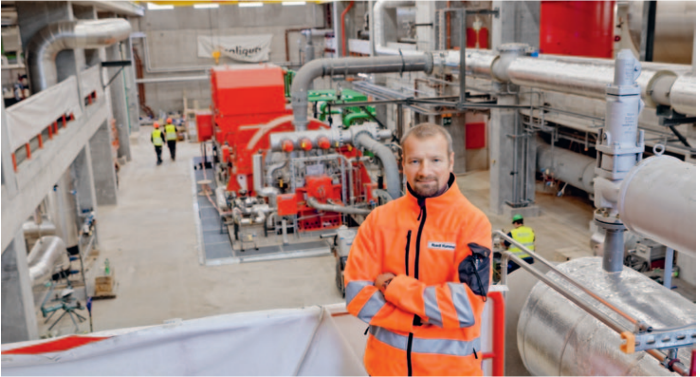
Ruedi Kummer im «Herzen» der Renergia: Ab 2015 werden hier aus Abfall Dampf, Strom und Wärme erzeugt.
