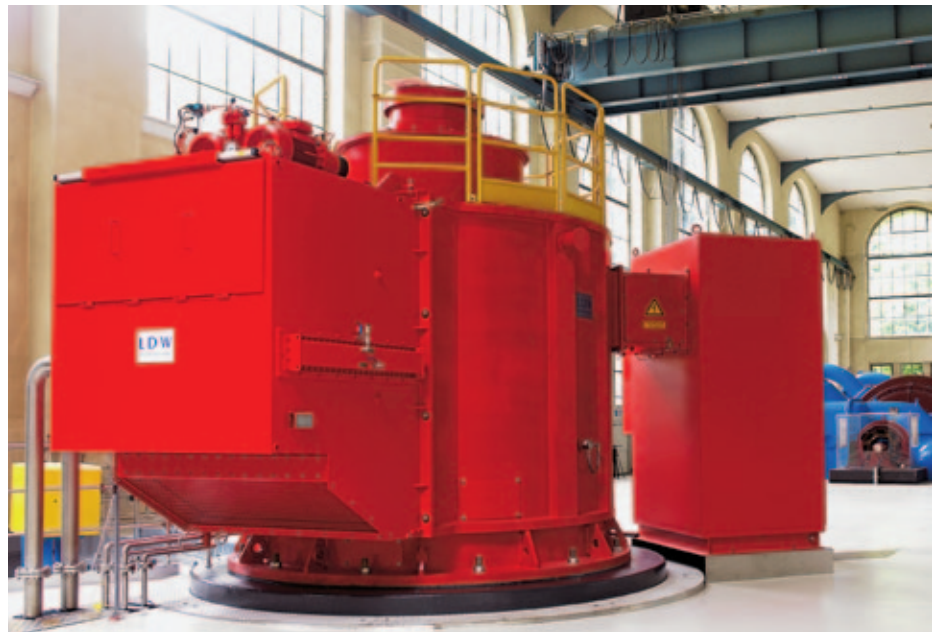
Mehr Leistung für das Kraftwerk Obermatt dank neuem Generator.
